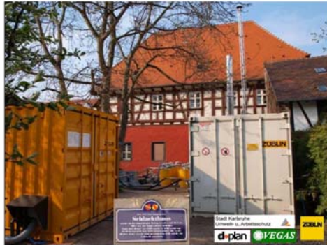
Abbildung 1: Sanierungsanlage vor dem ehemaligen Schlachthaus
