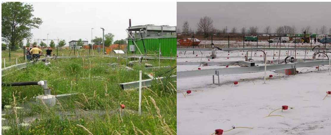
Abb. 4: Sanierungsfeld in Zeitz mit Injektions- und Extraktionsbrunnen und den Einrichtungen fürs Temperaturmonitoring (rote Kästchen)
